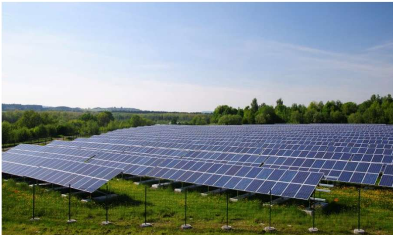
Beispiel für eine installierte Freiflächenanlage
