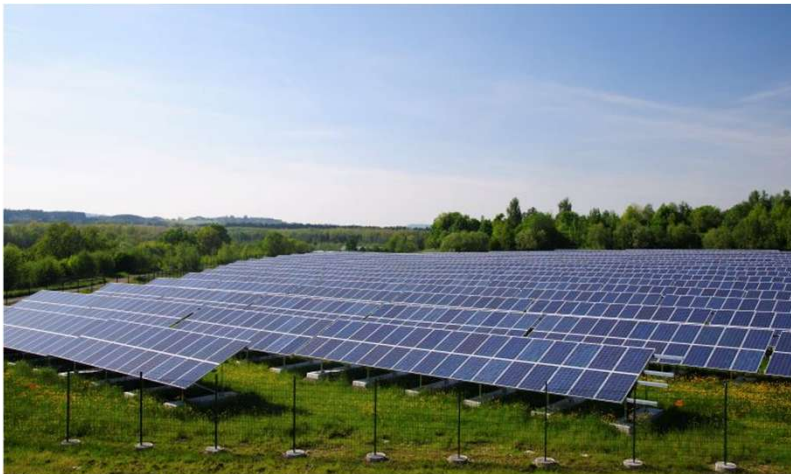
Beispiel für eine installierte Freiflächenanlage
